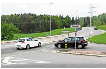
Belagsschäden im Bereich Moosrank müssen behoben werden. Dany Kammüller
